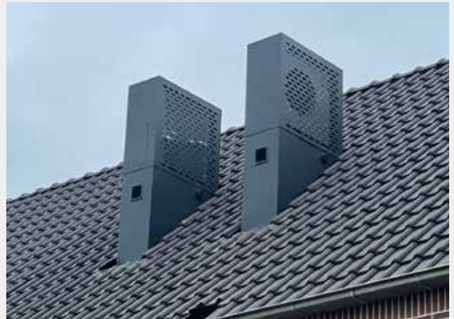
Geïntegreerde warmtepomp als schoorsteen
